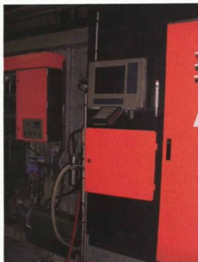
Photo 13. – Poste de commande (cliché D. Pomès).
